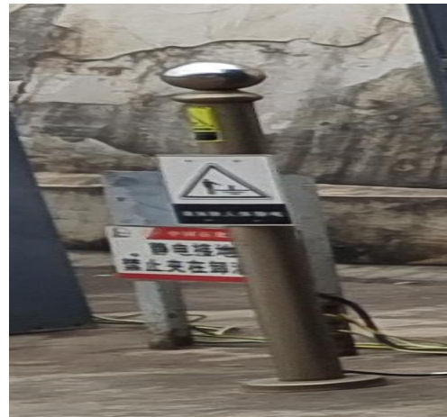
图 9 卸油区人体静电消除仪
