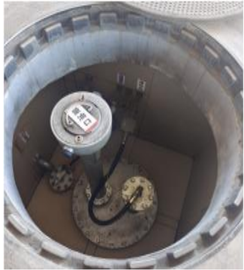
图 11 油罐操作井-柴油罐
